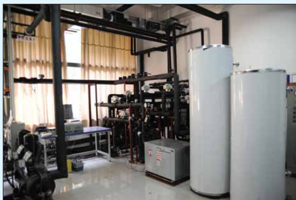
实验室地源热泵部分
