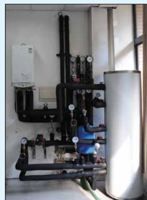
实验室燃气部分
